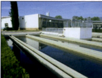
Figura 5. Vistas interiores ETAP Villa Azul, decantador.
