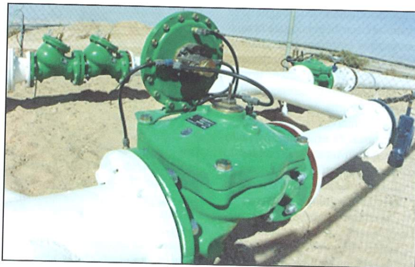
Figura 2. Válvula automática de regulación.
