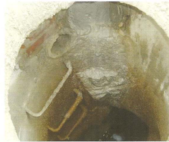
Figura 5. Otros ejemplos de uso inadecuado de nuestros saneamientos: vertidos de hormigones
