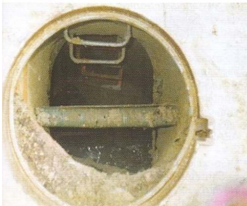
Figura 6. Más ejemplos de uso inadecuado de nuestros saneamientos: una canalización de telefonía atraviesa directamente un colector
