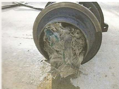
Figura 1. Problemas acarreados por fibras y bastoncillos en colectores y EDAR. Izquierda: bomba centrífuga colapsada; derecha: fibras extraídas del rotor de una bomba centrífuga
