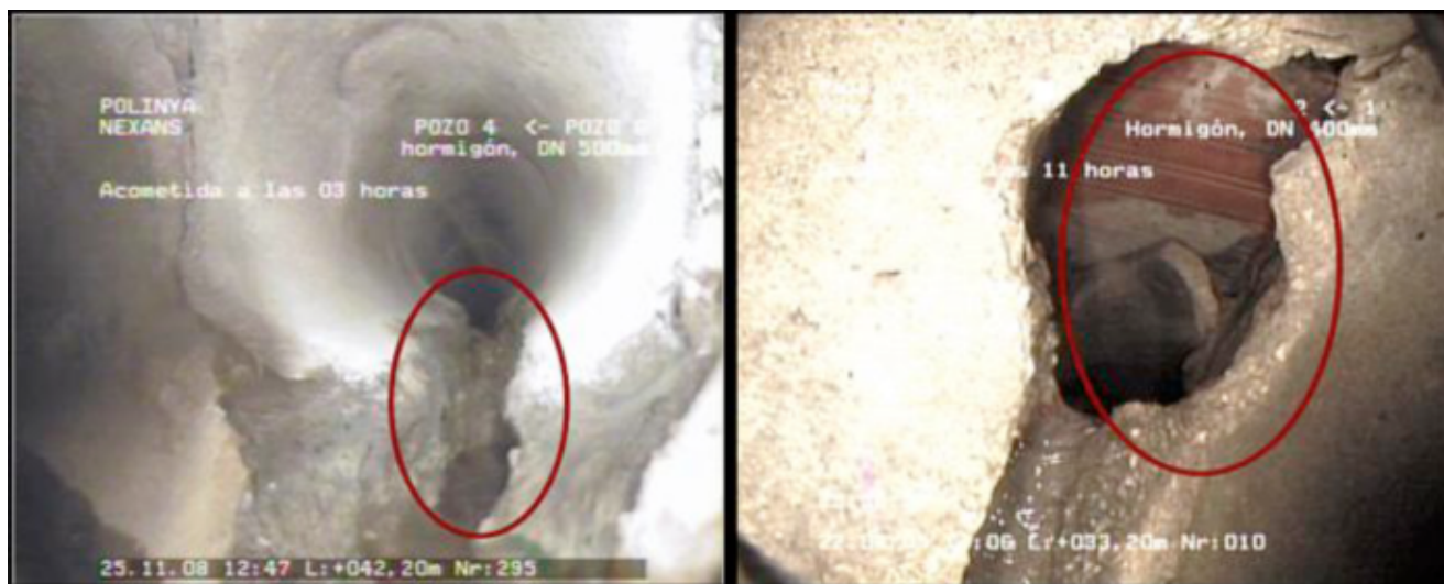
Figura 3. Deterioro de las redes de saneamiento: fisuras y roturas
