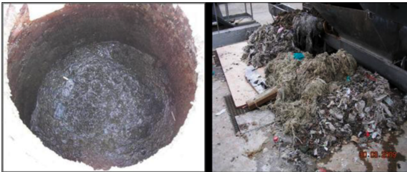
Figura 4. Izquierda, acumulación de grasas en un pozo de registro; derecha, restos sólidos extraídos en una estación elevadora de la red de saneamiento
