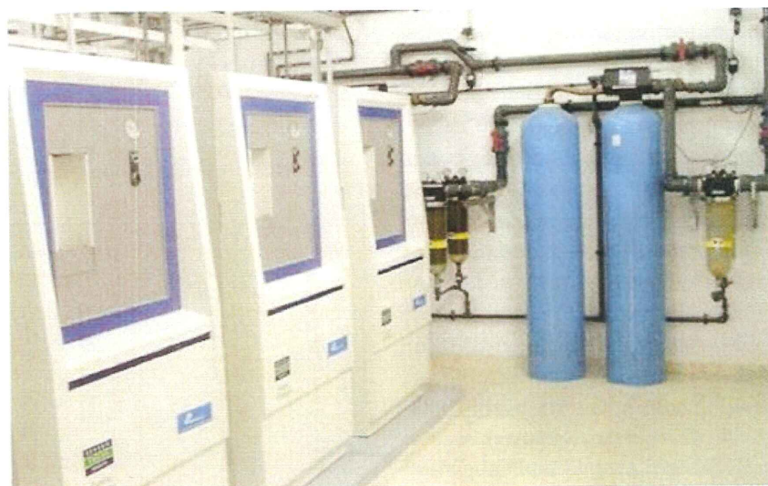
Fotografía 2. Instalación interior del sistema de dosificación de amoníaco gas: arriba, sistemas de control; abajo, descalcificadores de agua para dilución y tanques de amoníaco
